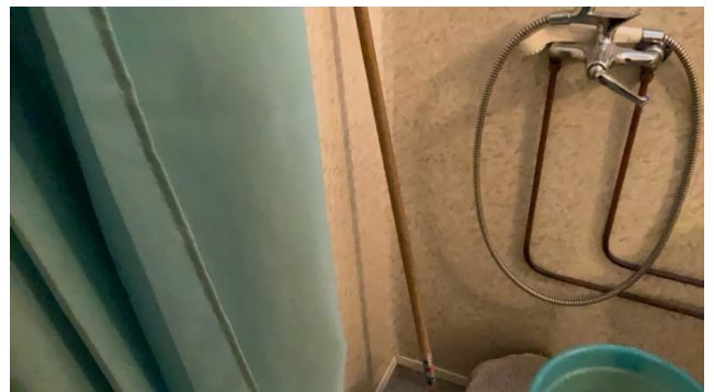
Tapet fra byggeår i dusjsone
