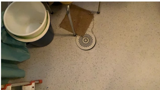
Belegg fra 2019 på gulv.
