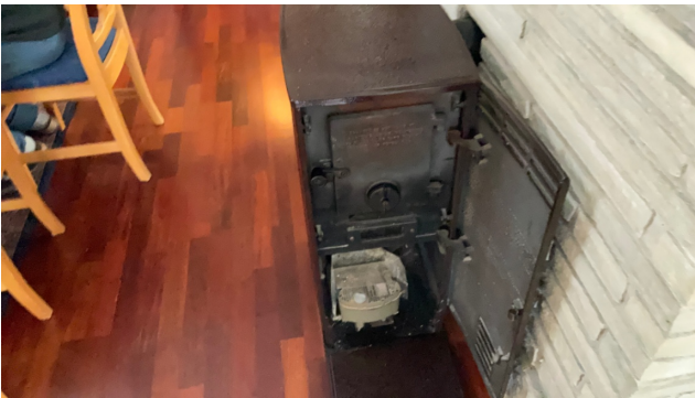
Kamin tilkoblet dagtank i garasje.
