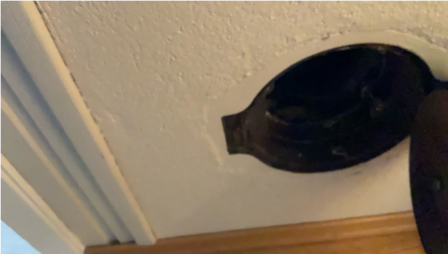
Sotluke i kjeller med manglende avstand til brennbart materiale.
