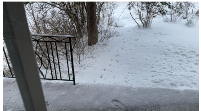
Manglende rekkverk på deler av terrasse i stueende.
