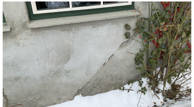
Skråriss ved vindu stue underetasje
