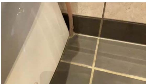
Rørgjennomføring i gulv uten mansjett
