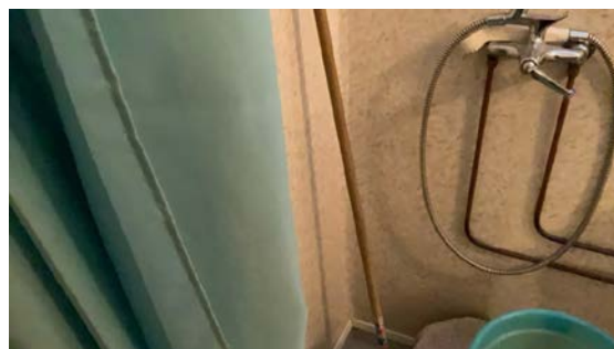
Tapet fra byggeår i dusjsone
