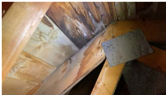
Spor etter tidligere lekkasjer ved pipe og taggjennomføringer.
