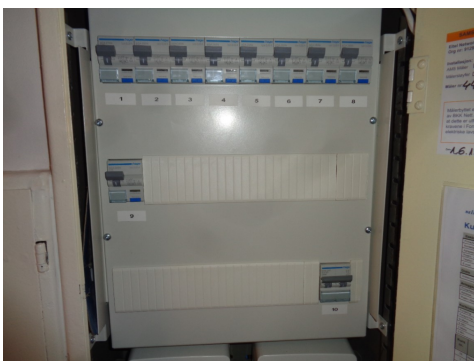
Sikringsskap i felles gang.
