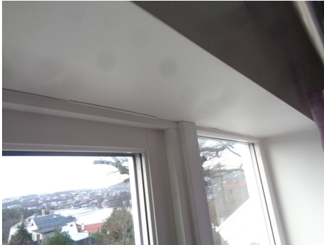
Lekkasje ved vindu ved altandør.
