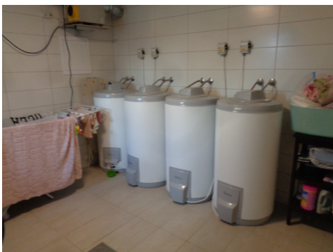
Varmtvannsberedere for seksjonen på vaskerom.
