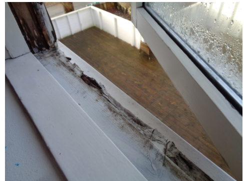
Råteskader i karmen.
