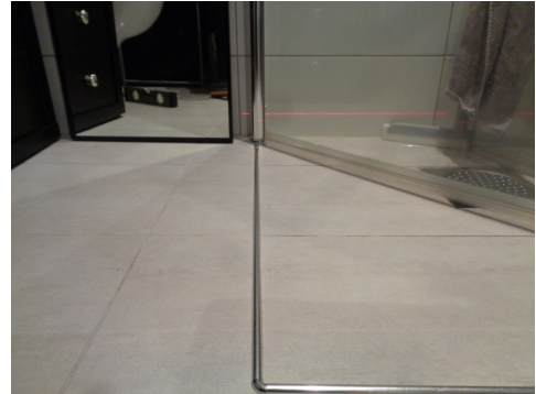
Stoppelist på gulv ved dusjsone.
