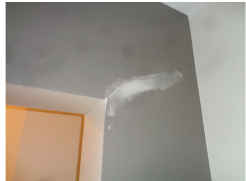
Sprekk på vegg.
