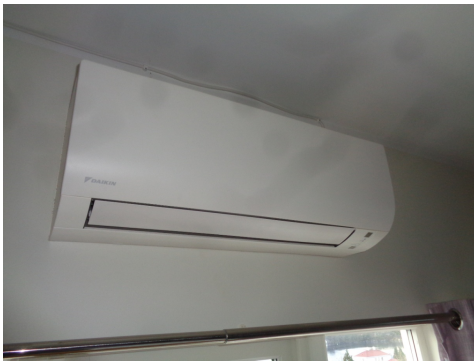
Varmepumpe i stue.
