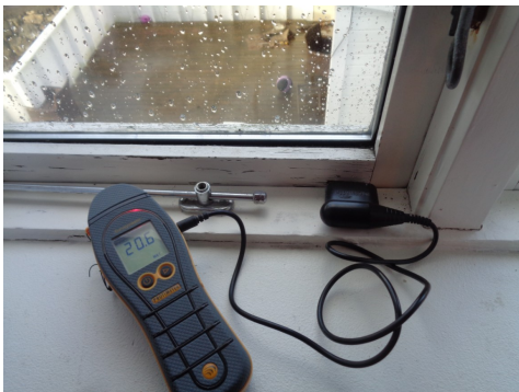
Fuktverdier i karmen.
