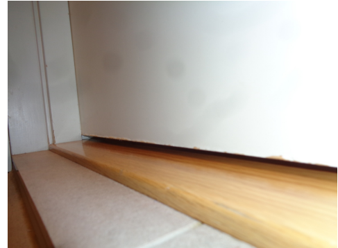
Noe slitasje på dørblad til bad.
