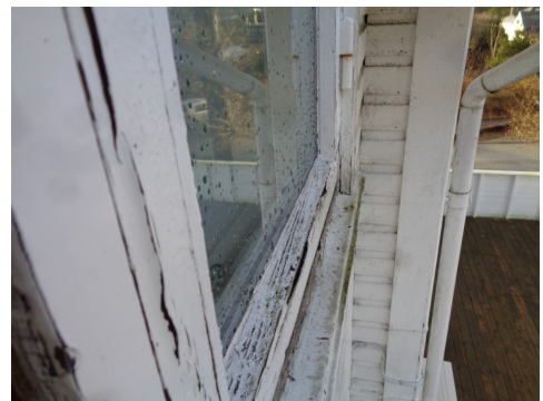
Vindu må skiftes.
