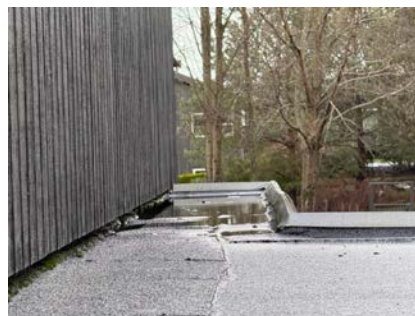
Vannsamling tak over carport, mose mot yttervegg.
