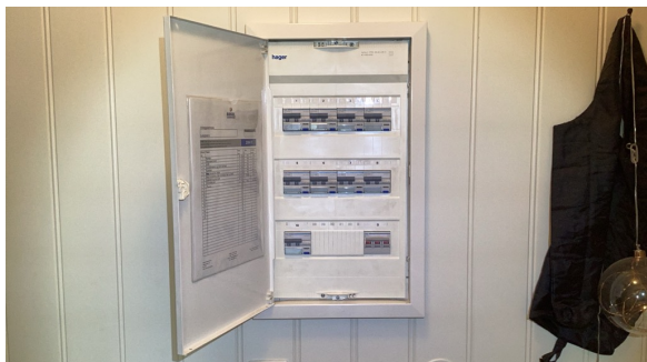
Sikringsskap på teknisk rom.
