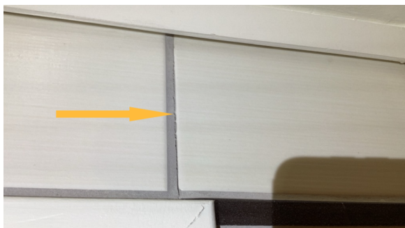
Riss i fuge.
