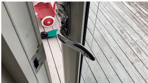
Noe slark i vrider på terrassedør.
