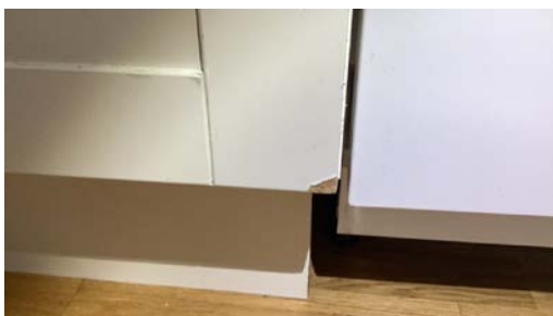
Svelleskade på skapdør.
