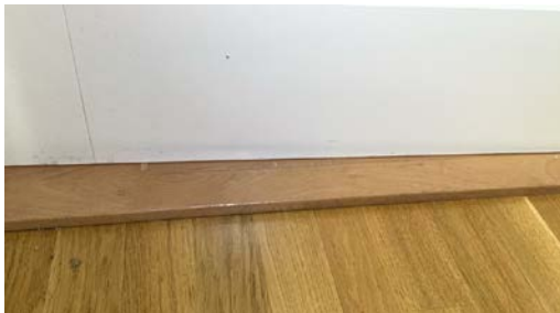
Dør til soverom tar i terskel.
