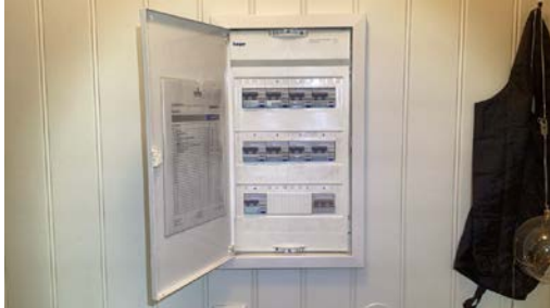
Sikringsskap på teknisk rom.
