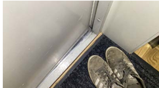
Inngangsdør tar borti terskel.
