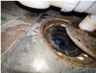
Begrenset tilgang til sluk under dusjkabinett, sluk bør rengjøres.
