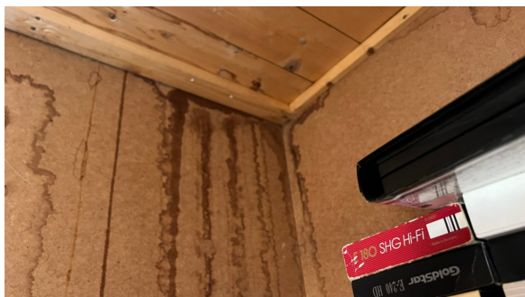
Eksempel på fuktskade på veggoverflate på loftet
