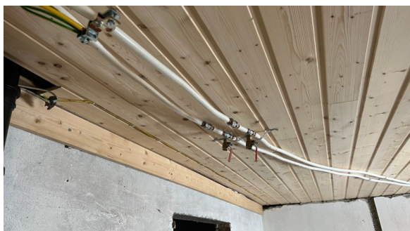
Eksempel på ufagmessig utførelse av vannrør
