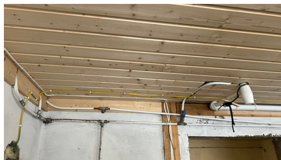
Eksempel på ufagmessig utførelse av vannrør
