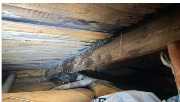
Det renner vann langs sperre og taktro ved pipen.
