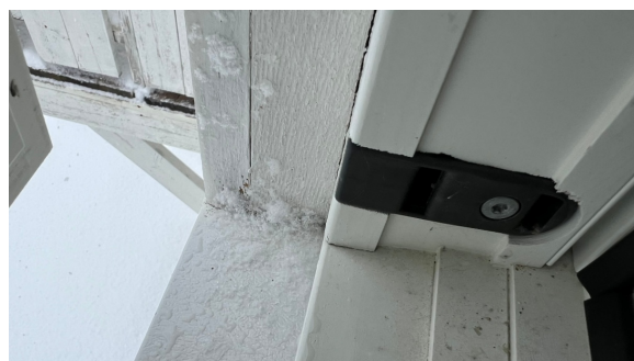
Omrammingen på vinduet er ført helt med til beslaget. Dette øker vannpåkjenningen mot trevirket og reduserer levetiden til omrammingen.
