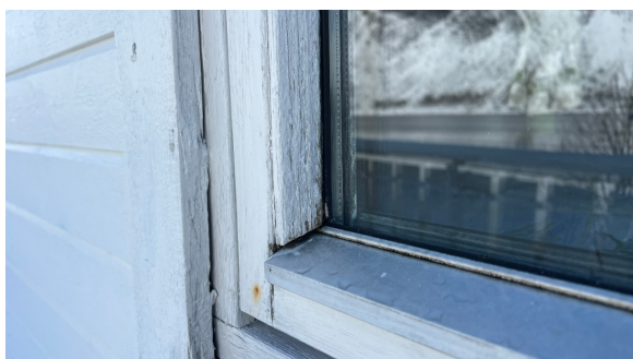
Eksempel på utvendig vedlikeholdsbehov på vindu.
