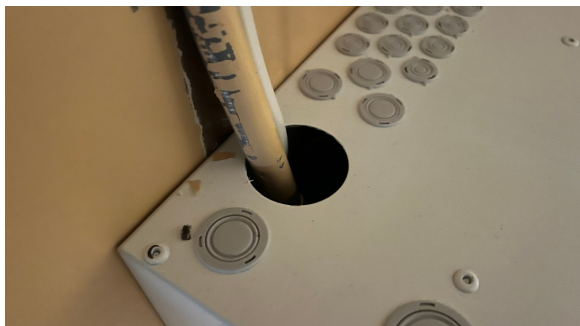
Kabel inn til sikringsskapet mangler foring/beskyttelse mot metallskapet.
