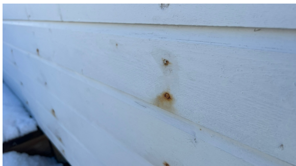
Eksempel på rustvannavrenning fra spiker.
