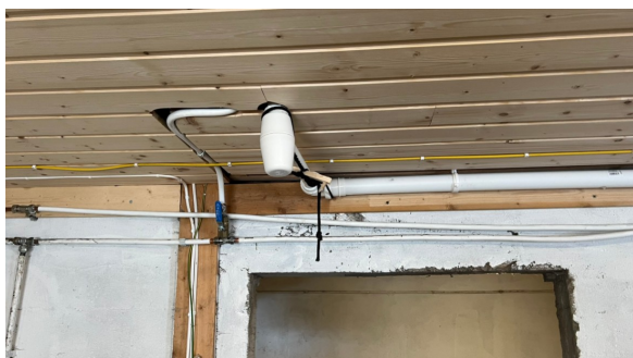
Eksempel på ufagmessig rørarbeid.
