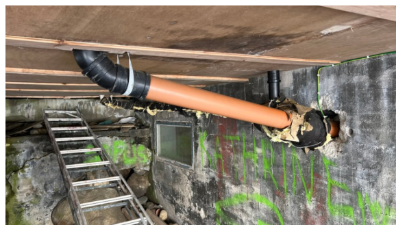
Avløpsrør utvendig må frostsikres
