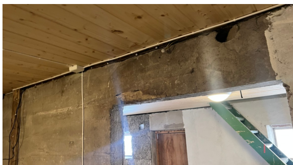
Manglende rekkverk på trappen
