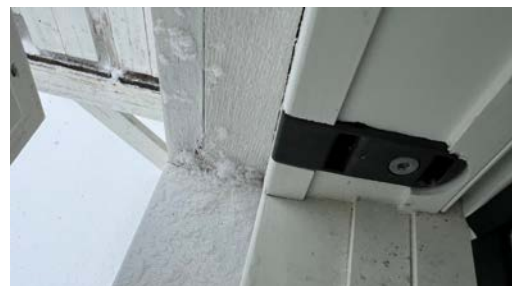
Omrammingen på vinduet er ført helt med til beslaget. Dette øker vannpåkjenningen mot trevirket og reduserer levetiden til omrammingen.
