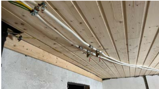
Eksempel på ufagmessig utførelse av vannrør
