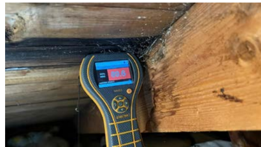
Fuktmålingen viser at trevirket er mettet med vann. Det har oppstått råteskader i taktro.
