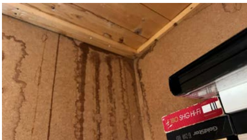
Eksempel på fuktskade på veggoverflate på loftet
