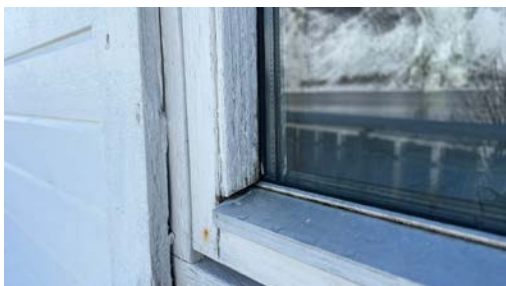
Eksempel på utvendig vedlikeholdsbehov på vindu.
