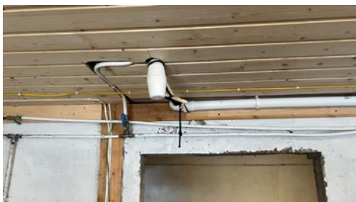
Eksempel på ufagmessig rørarbeid.
