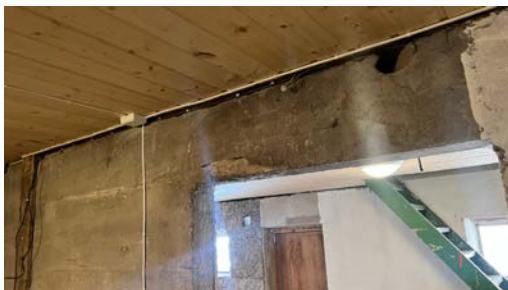
Manglende rekkverk på trappen
