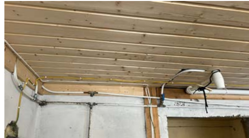
Eksempel på ufagmessig utførelse av vannrør
