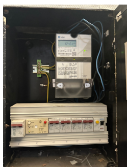
Sikringsskap med automatsikringer.
