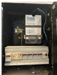
Sikringsskap med automatsikringer.
