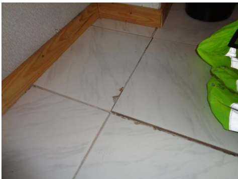
Dårlige fuger på gulv i biinngang.
