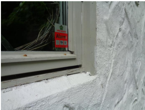
Det mangler noe tetting rundt vinduer.
