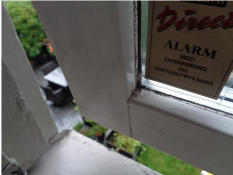
Noe kondensmerker i karmen.
