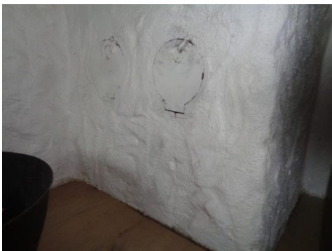
Ikke ubrennbar plate under feieluke.
