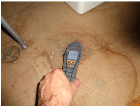
Eldre fuktmerker på gulv.
