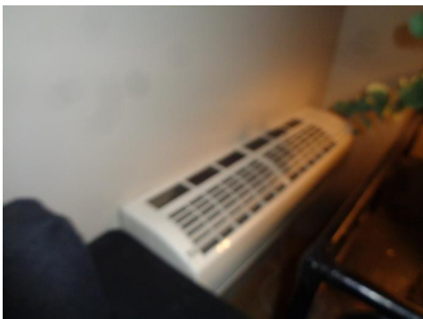
Varmepumpe i stue.
