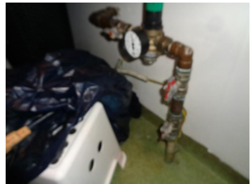
Stoppekran på vaskerom
