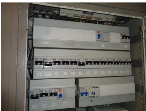
Sikringsskap i entrè.
