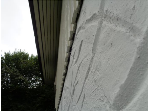
Stedvis lite lufting i kløedningen.
