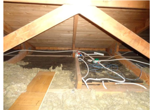
Eldre fuktmerker på sutaksbord.
