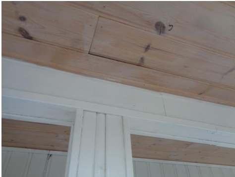
Oppsprekk i panel i vinterhave
