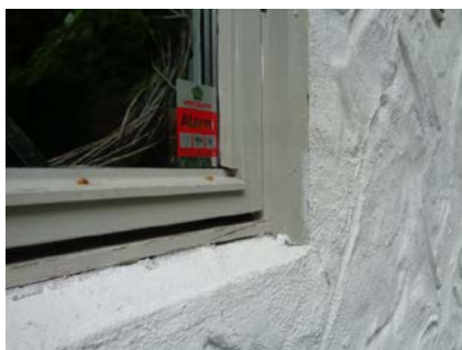
Det mangler noe tetting rundt vinduer.
