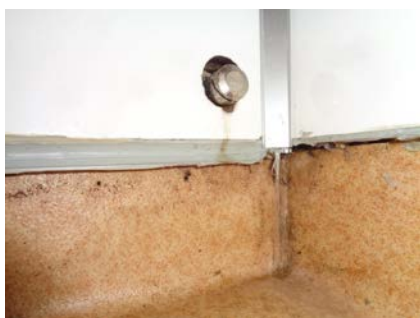
Plugget rør i dusjsone.
