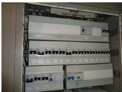
Sikringskap i entrè.
