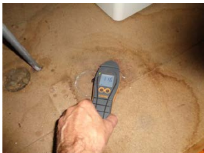
Eldre fuktmerker på gulv.
