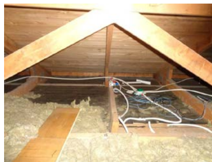
Eldre fuktmerker på sutaksbord.
