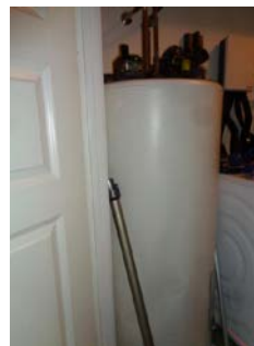
Varmtvannsbøder på vaskerom.
