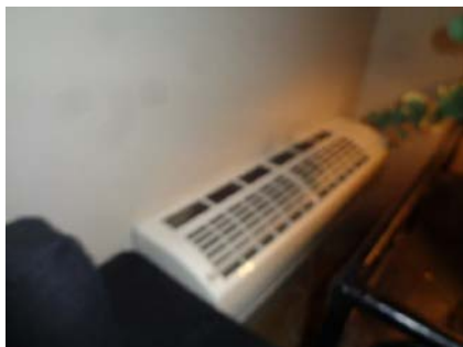
Varmepumpe i stue.
