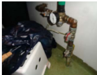
Stoppekran på vaskerom
