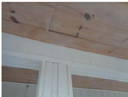
Oppsprekk i panel i vinterhave
