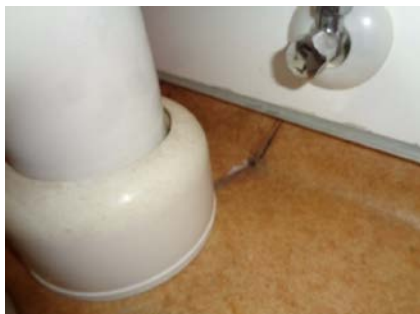
Sprekke i belegg.
