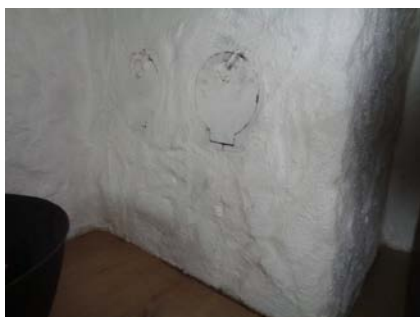
Ikke ubrennbar plate under feieluke.
