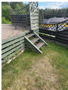
Bildet viser trapp til terrasse uten rekkverk.
