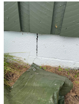
Bildet viser sprekke i grunnmuren ved trappenedgangen.
