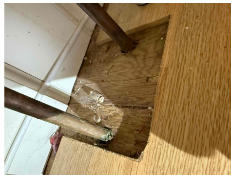
Bildet viser rørgjennomføring i kjøkkenbenk med tegn på eldre fuktskade.
