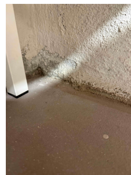
Bildet viser indikasjon på saltutslag i muren.
