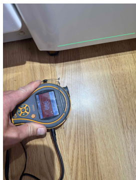
Bildet viser indikasjon på fuktutslag.
