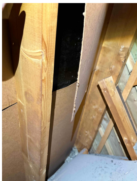
Bildet viser undertaksplate som har løsnet.
