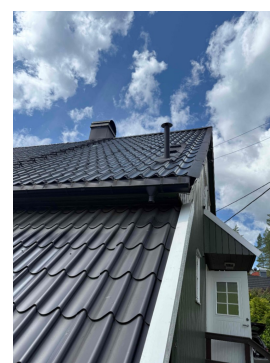
Bildet viser vindski som heller utover og har mangelfull innfesting, noe som kan føre til at delen løsner ved belastning.
