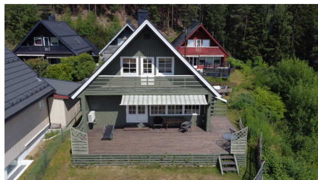
Bildet viser terrassene med manglende rekkverk.
