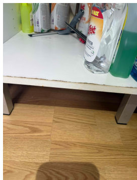
Bildet visere svelling i benkeskap.
