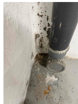
Bildet viser indikasjon på saltutslag i muren.
