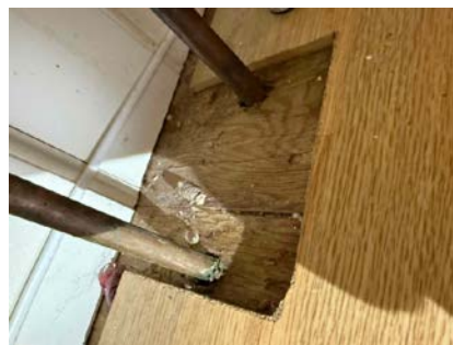
Bildet viser rørgjennomføring i kjøkkenbenk med tegn på eldre fuktskade.
