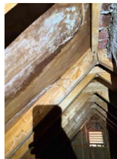
Bildet viser fuktskader på undertaket. Årsaken er ikke kjent.
