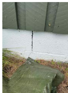
Bildet viser sprekk i grunnmuren ved trappenedgangen.
