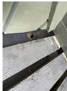
Bilde viser hull i tekkingen på balkongen.
