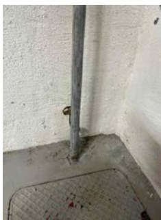
Bildet viser vannrør i kjelleren
