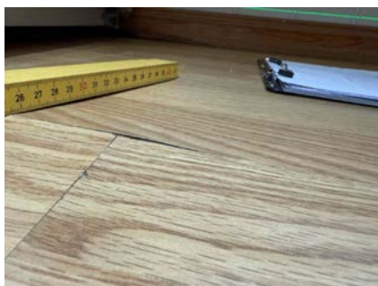
Bildet viser området foran kjøleskapet med synlig hevelse/svelling i laminatgulvet.
