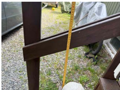
Bildet viser åpninger i rekkverket på trappen til inngangspartiet.
