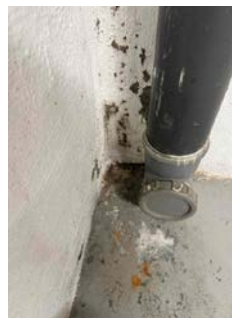
Bildet viser indikasjon på saltutslag i muren.
