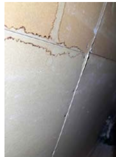
Bildet viser fuktskjolder i boden i 2 etasje.
