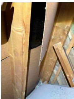
Bildet viser undertaksplate som har løsnet.
