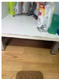
Bildet visere svelling i benkeskap.
