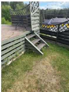
Bildet viser trapp til terrasse uten rekkverk.
