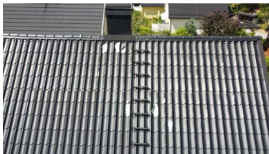
Bildet viser begynnende avflassing av overflatebehandling og rustdannelse på takteking-
