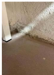
Bildet viser indikasjon på saltutslag i muren.
