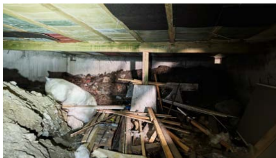
Det er påvist noe provisoriske understøttelser av etasjeskiller.
