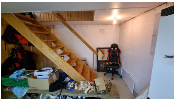
Trapp mellom 1. etasje og kjelleretasje mangler rekkverk, og åpninger mellom trinn overstiger 10 cm.
