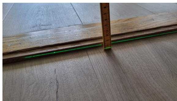
Kontroll av planavvik.
