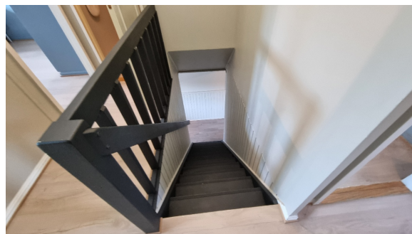
Det er ikke håndløper på begge sider i trappeløpet.
