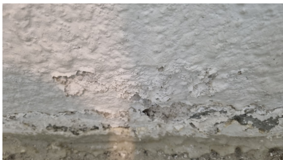
Saltutslag i grunnmur.
