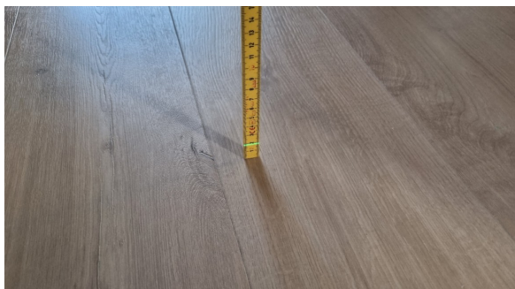
Kontroll av planavvik.
