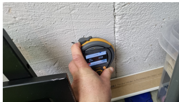
Det ble registrert forhøyde fuktverdier.
