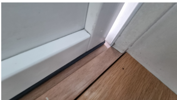
Dørblad på balkongdør i 1. etasjen subber mot karm.
