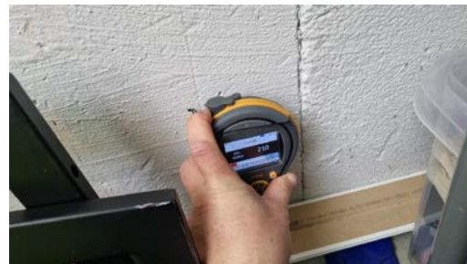
Det ble registrert forhøyde fuktverdier.
