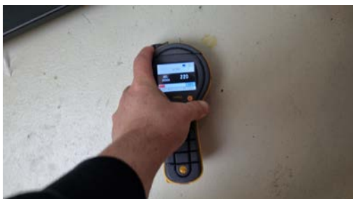
Det ble registrert forhøyde fuktverdier.
