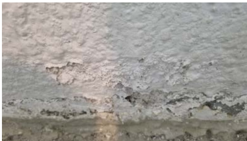
Saltutslag i grunnmur.
