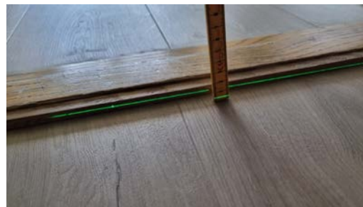
Kontroll av planavvik.
