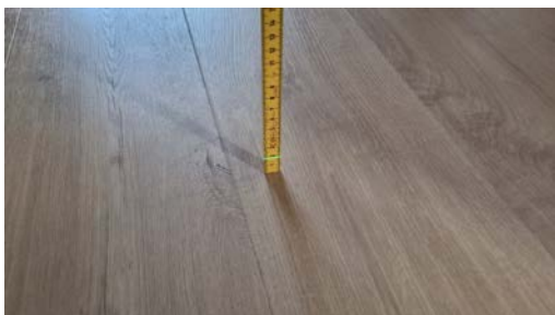
Kontroll av planavvik.
