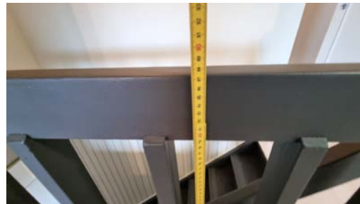
Rekkverkshøyder er under dagens forskriftskrav til rekkverk i trapper.
