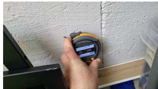
Det ble registrert forhøyde fuktverdier.
