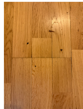
Fuktskadet parkettskjøt på lite soverom
