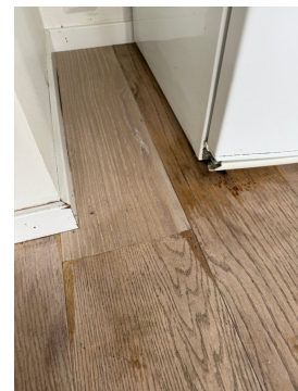
Fuktskadet parkett ved kjøleskap.
