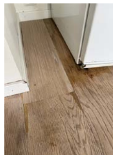
Fuktskadet parkett ved kjøleskap.
