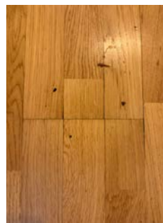
Fuktskadet parkettskjøt på lite soverom
