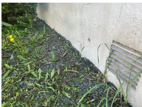
Synlig grunnmursplast på grunnmur.
