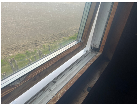
Vindu på unnredet loftstue har rustflekker på metallist mellom glass, som er tegn på utettheter og punkttert glass.
