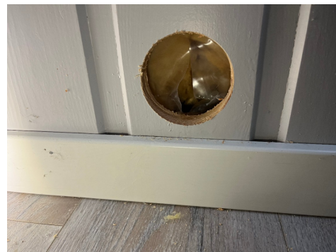
Observert plast i utforet vegg, som kan skape fuktskader.
