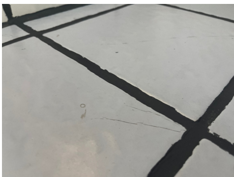
Sprekk/riss i gulvflis.
