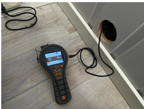
Fuktmåling i utforet vegg viste skadelig fukt.
