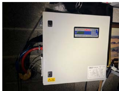
Styring til renseanlegget i garasje/bod.
