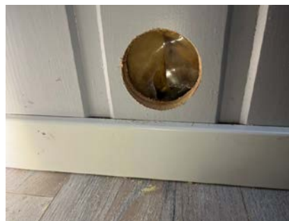
Observert plast i utforet vegg, som kan skape fuktskader.
