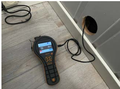
Fuktmåling i utforet vegg viste skadelig fukt.
