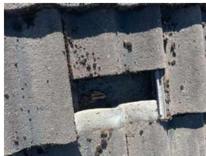
Betongtakstein med papp undertak iht. stikkprøver.
