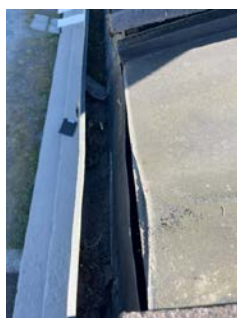
Skottrenne er ikke tett i overgang til takrenne.
