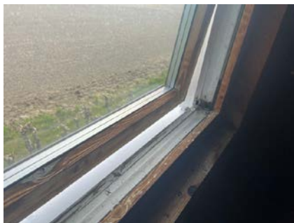
Vindu på uinnredet loftsrom har rustflekker på metallist mellom glass, som er tegn på utettheter og punktert glass.
