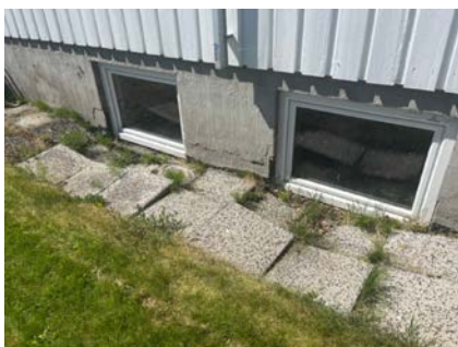
PVC kjellervinduer er ikke ferdigstilt.
