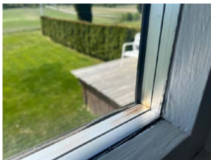
Vindu leilighet med tegn til punktert glass.
