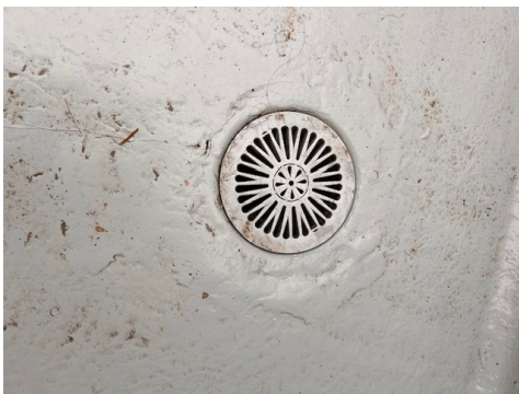
Sprekker i glassfiber rundt sluk
