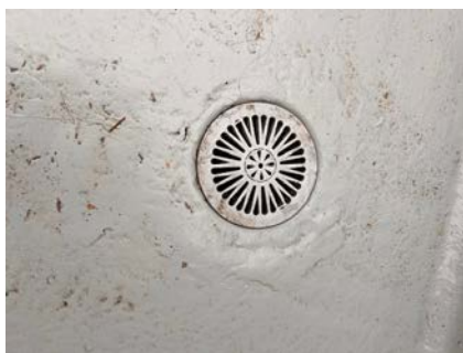
Sprekker i glassfiber rundt sluk
