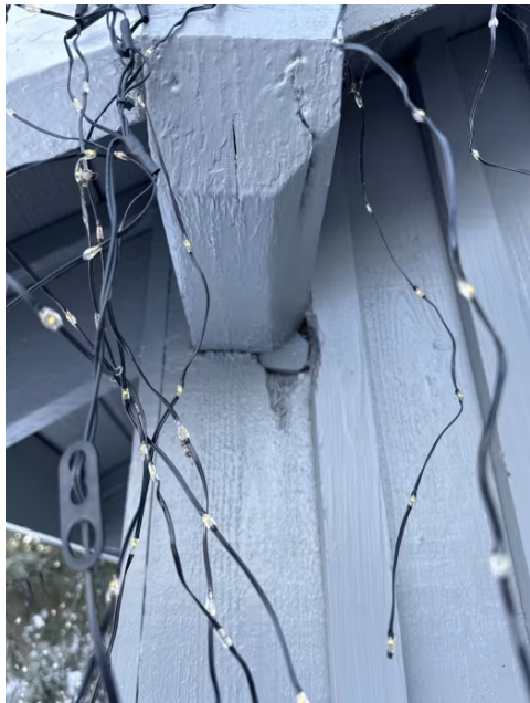
Viser skade ved kledning.
