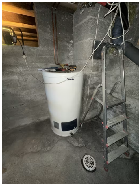
Viser varmtvannsbereder plassert i kjeller.
