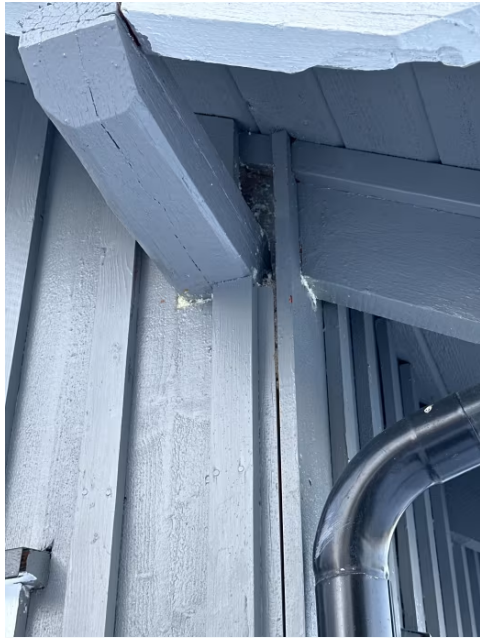
Det registreres glippe og åpning ved hjørnekasse.
