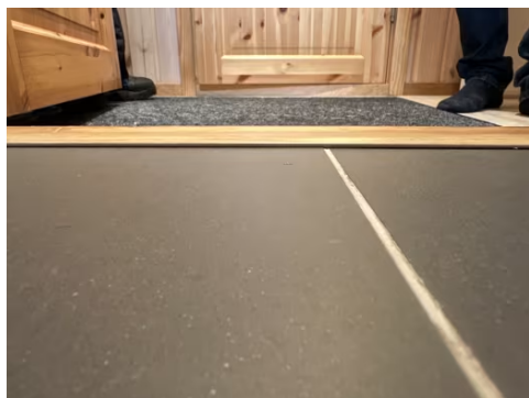
Ingen synlig oppbrett av membran ved døråpning.
