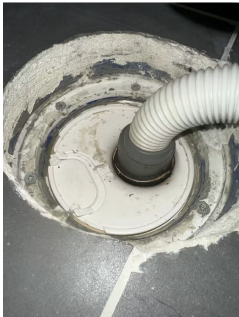
Det registreres ufagmessig utførelse rundt sluk.
