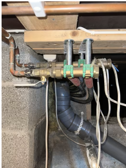
Viser åpne fordelene i tak i kjeller.
