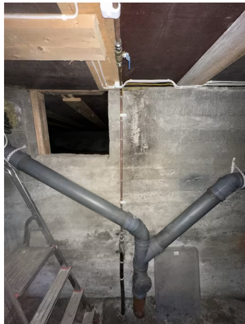
Viser avløpsrør og stakeluke i kjeller.
