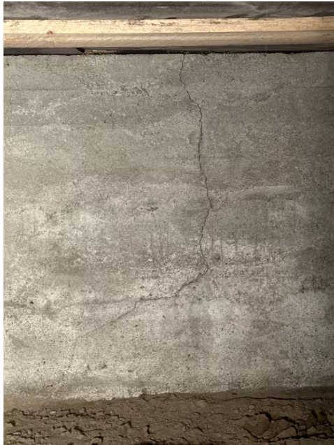
Viser sprekk i ringmur, bilde tatt i krypkjeller.
