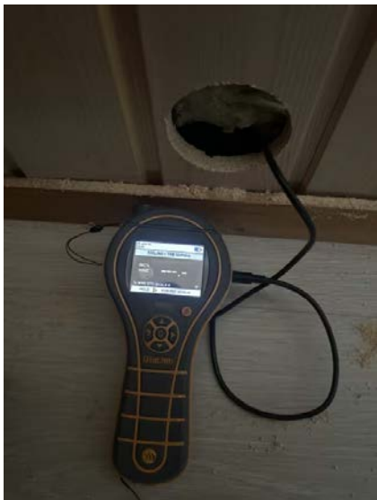
Det er foretatt hulltaking med 73 mm hullbor fra tilstøtende rom (gang). Undersøkelsen viser ingen tegn til skader eller fukt i konstruksjonen ved hull.
