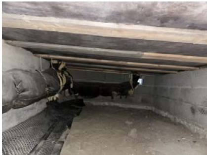
Viser isolert avløpsrør i krypkjeller. Bilde tatt fra gulvluke i bod.
