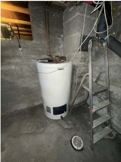
Viser varmtvannsbereder plassert i kjeller.
