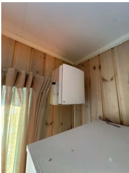
Miniventilasjon fra flexit. Montert på soverom 2.etasje og i stue 1.etasje.
