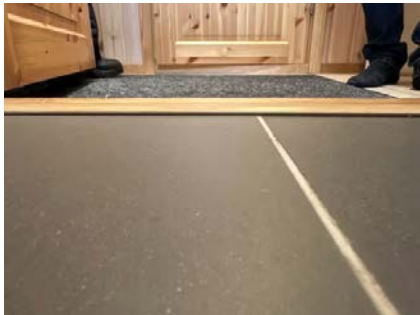
Ingen synlig oppbrett av membran ved døråpning.
