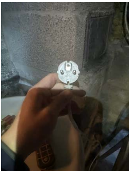
Ingen tegn til varmgang ved støpsel. Anbefales å etablere fast tilkobling.
