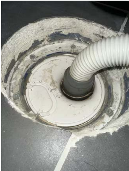
Det registreres ufagmessig utførelse rundt sluk.
