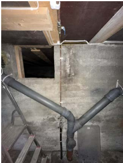
Viser hovedinntekt, ettermontert ny stoppekran etter gammel kran neders på bilde.
