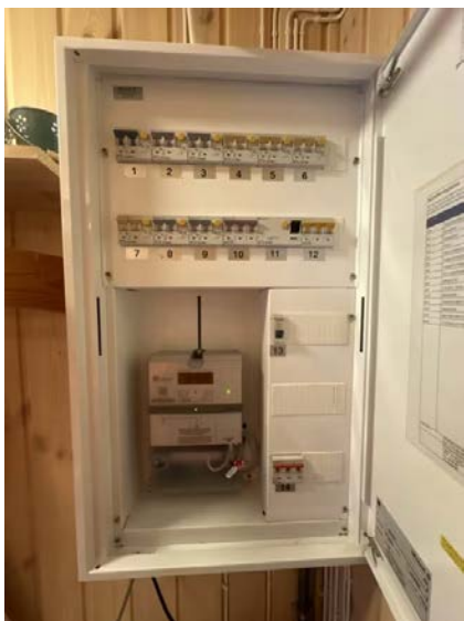
Viser vegghengt sikringsskap plassert i bod 1.etasje med overbelastningsvern 40A, måler og jordfeilbrytere.
