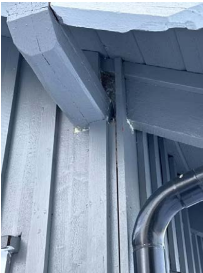
Det registreres glippe og åpning ved hjørnekasse.
