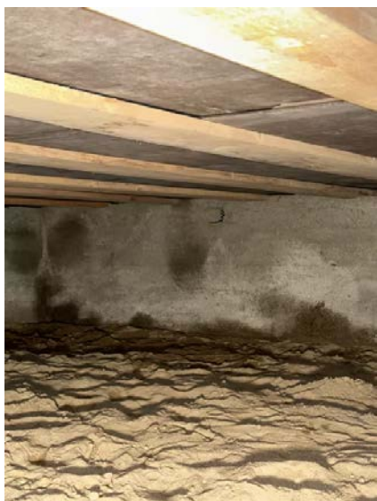
Det registreres bløt jord/sandmasser i hjørnet i krypkjeller. Det registreres salt/kalkutslag på innvendig grunnmursflater i krypkjeller.
