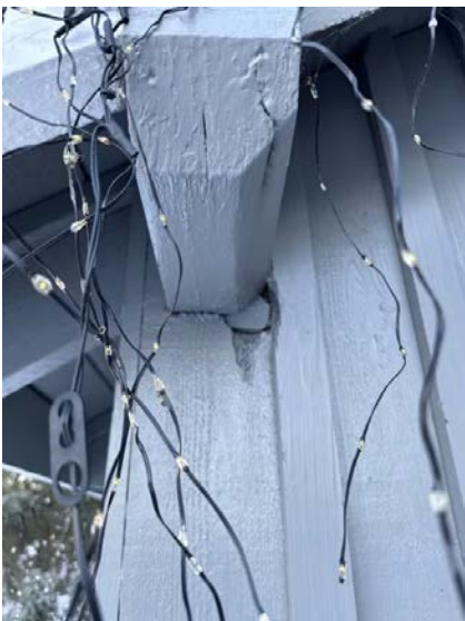
Viser skade ved kledning.
