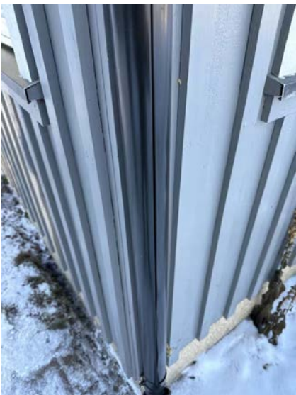
Viser buling/skade i nedløpsrør som er et symptom på frostspreng.
