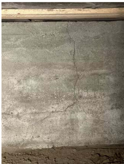
Viser sprekke i ringmur, bilde tatt i krypkjeller.
