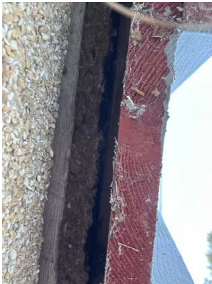
Det registreres stedvis mangelfull lufting av kledningen.
