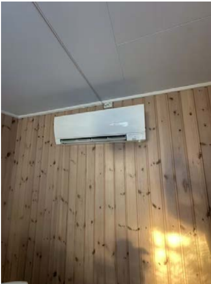
Viser innedel montert i stue.
