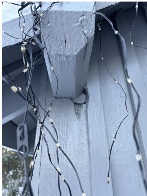
Viser skade ved kledning.
