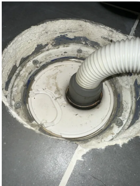
Det registreres ufagmessig utførelse rundt sluk.
