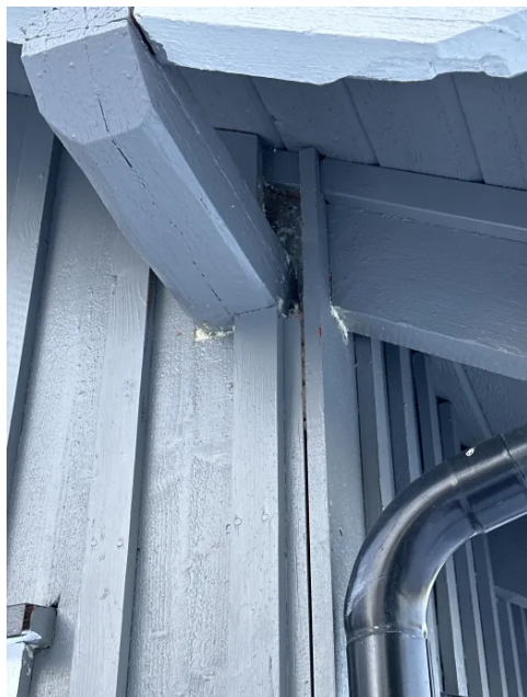
Det registreres glippe og åpning ved hjørnekasse.
