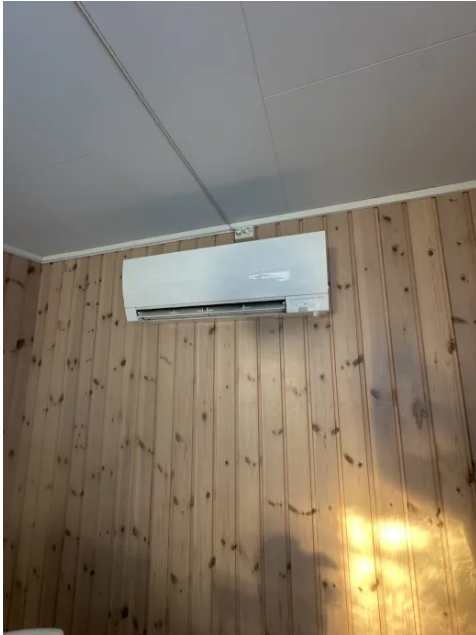
Viser innedel montert i stue.
