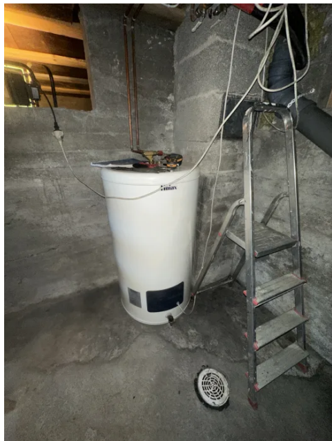
Viser varmtvannsbereider plassert i kjeller.
