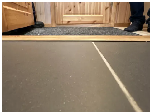
Ingen synlig oppbrett av membran ved døråpning.
