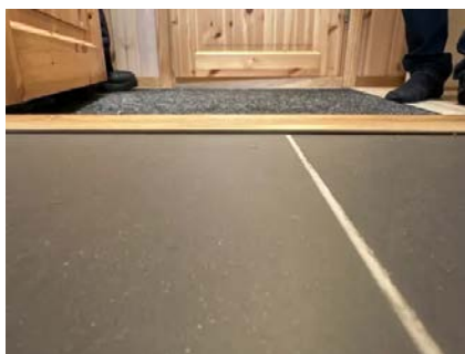
Ingen synlig oppbrekk av membran ved døråpning.
