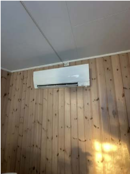
Viser innedel montert i stue.
