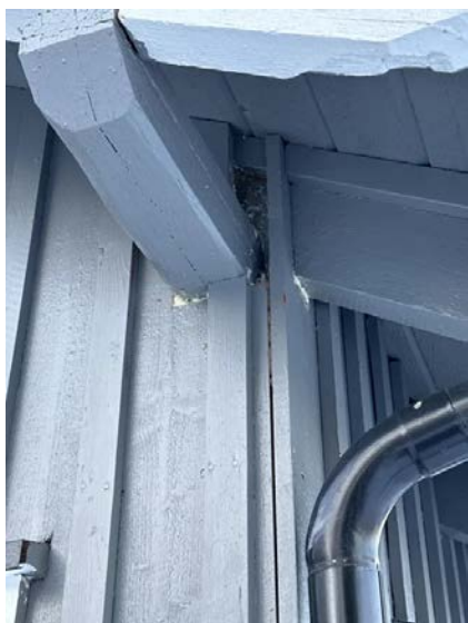
Det registreres glippe og åpning ved hjørnekasse.
