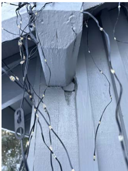
Viser skade ved kledning.
