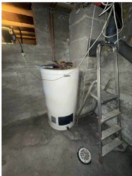
Viser varmtvannsbereider plassert i kjeller.
