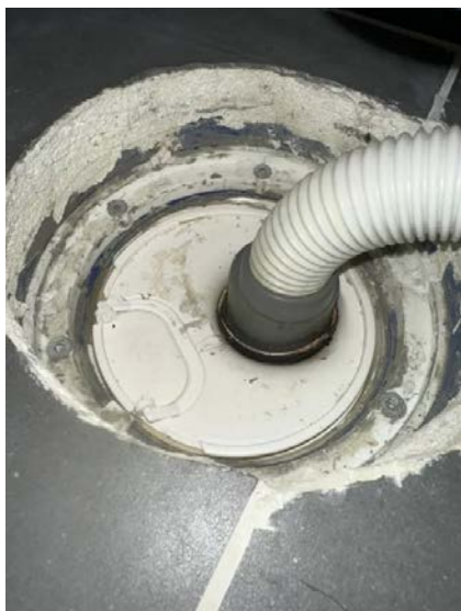
Det registreres ufagmessig utførelse rundt sluk.
