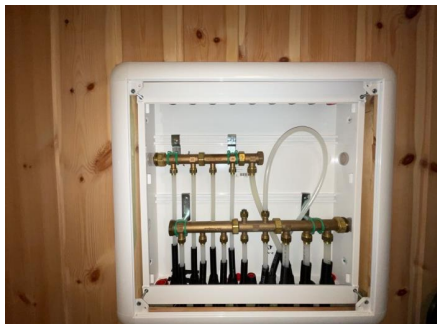
Vannfordelingskap, mangler merking på kurser
