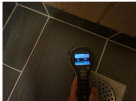
Fuktsøk er utført på gulv ved vaskekum og sluk uten forhøyde fuktavvik.
