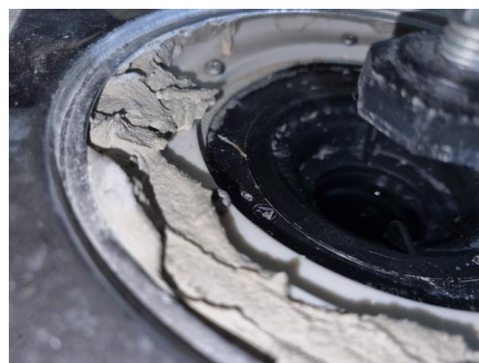
Sluk med synlig klemt mansjett under skrudd klemring
