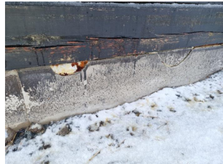
Skade på enkelte grunnmursplater slik at isolasjon er synlig
