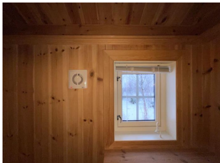
Mekanisk avtrekk på vegg og åpningsvindu med ventil.
