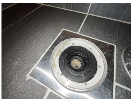
Sluk ved vaskekum med synlig klemt slukmansjett
