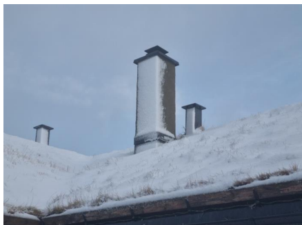
Manglende takstige og feie plattform opp til pipe
