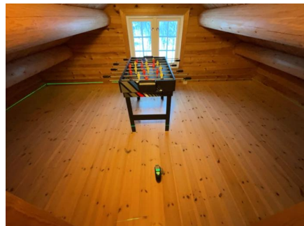
Hems Plassering av laser ved kontroll av Allrom 2. Det er målt 12 mm høydeforskjell gjennom rommet. TG 1. Over en avstand på 2 meter er det målt 12 mm fra hjørne mot allrom 1 i retning ytre hjørne. TG 2
