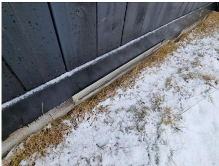
På gavelvegg er en grunnmursplate løsnet
