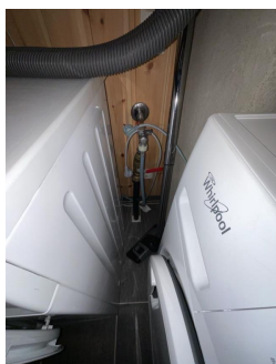
Hovedstoppekrane er plassert ved vaskemaskin under varmtvannsberederen
