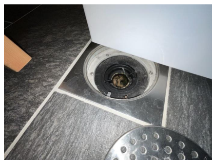
Sluk ved vaskemaskin med synlig klemt slukmansjett
