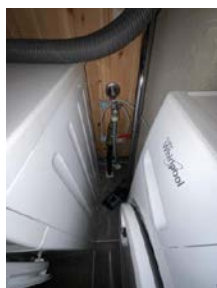
Hovedstoppekrane er plassert ved vaskemaskin under varmtvannsberederen
