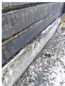
Grunnmursplater er presset ut på deler av grunnmuren
