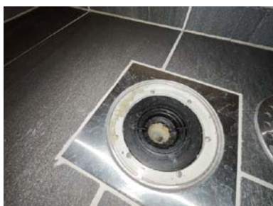
Sluk ved vaskeikum med synlig klemt slukmansjett
