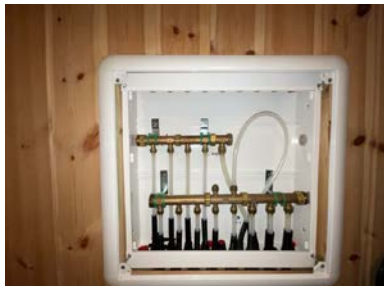
Vannfordelingsskap, mangler merking på kurser
