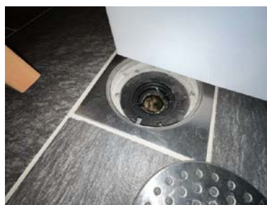
Sluk ved vaskemaskin med synlig klemt slukmansjett
