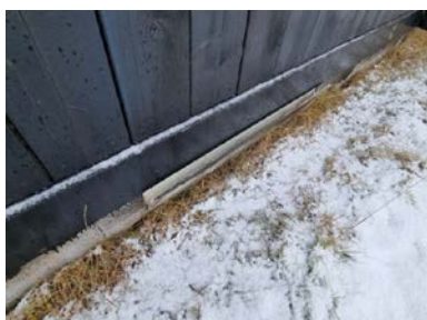
På gavelvegg er en grunnmursplate løsnet
