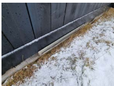
På gavelvegg er en grunnmursplate løsnet
