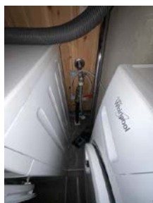
Hovedstoppekrane er plassert ved vaskemaskin under varmtvannsberederen
