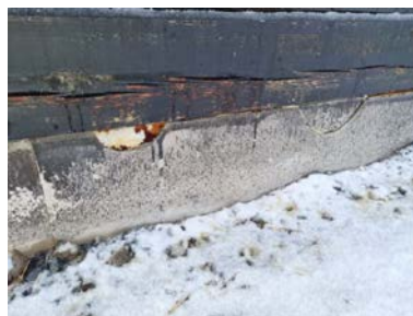
Skade på enkelte grunnmursplater slik at isolasjon er synlig
