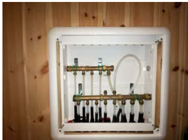
Vannfordelingsskap, mangler merking på kurser
