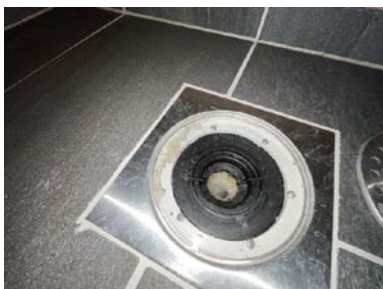
Sluk ved vaskeikum med synlig klemt slukmansjett
