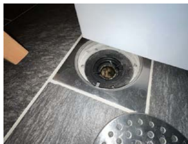
Sluk ved vaskemaskin med synlig klemt slukmansjett
