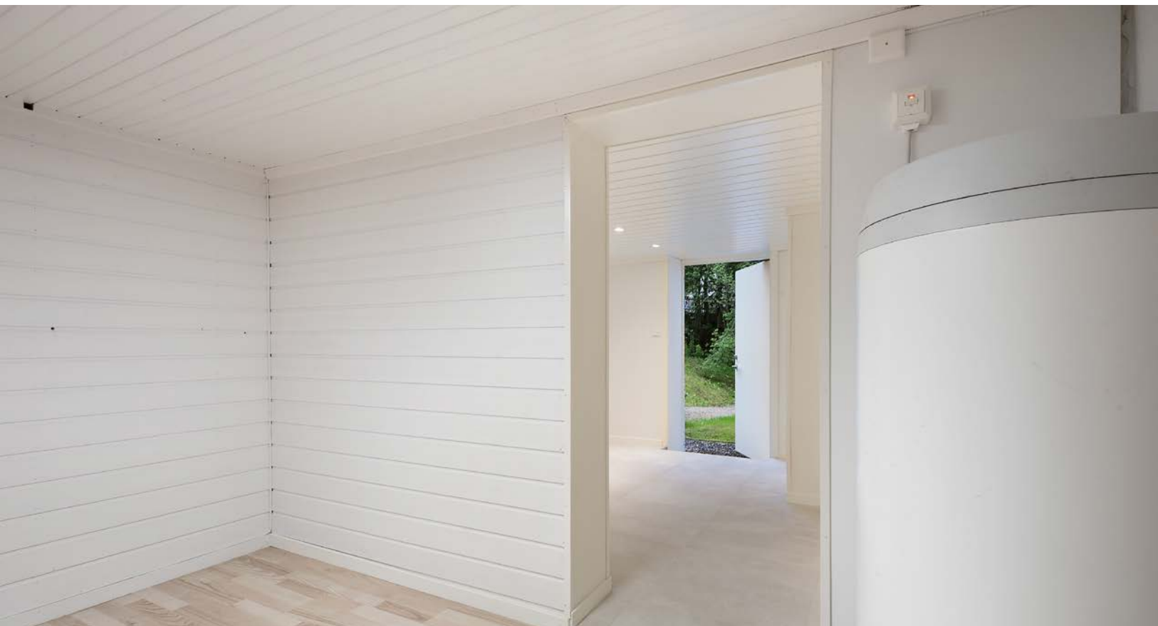
Teknisk rom/ bod i kjeller.
