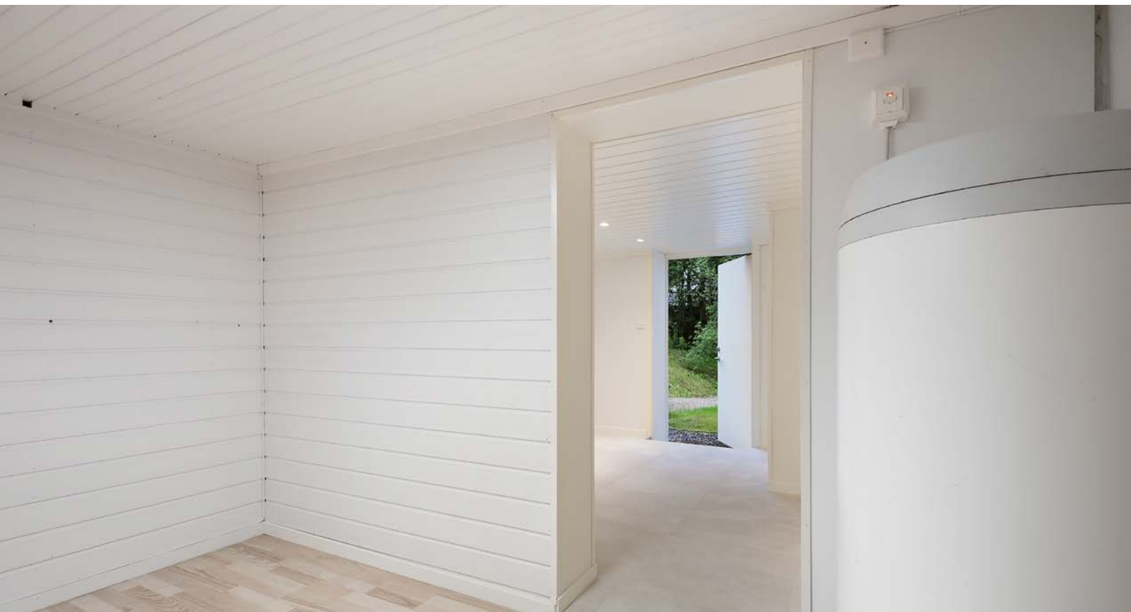
Teknisk rom/ bod i kjeller.
