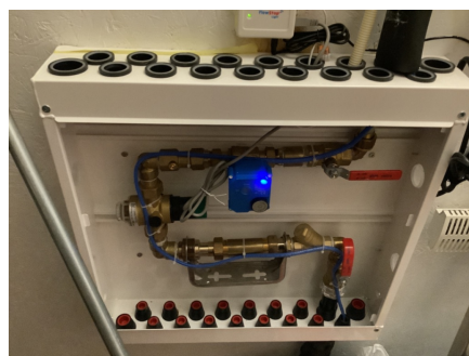
Vannfordelerskap i bod ved carport.
