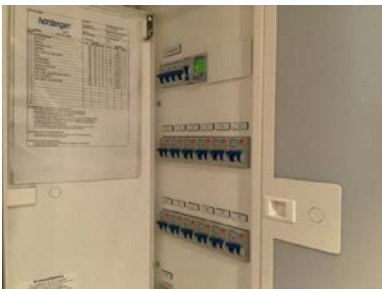
Sikringsskapet i entre.
