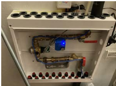
Vannfordelerskap i bod ved carport.
