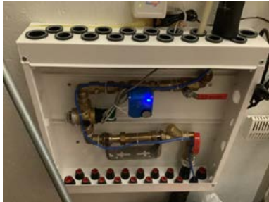
Vannfordelerskap i bod ved carport.
