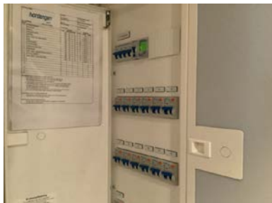
Sikringsskapet i entre.
