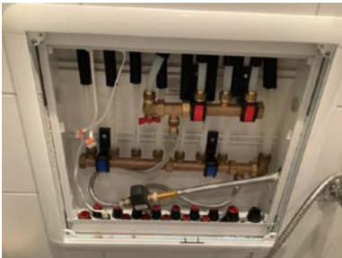
Vannfordelerskap i bad i 1. etg.
