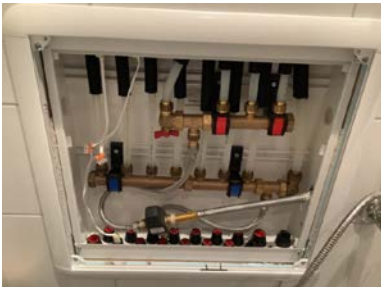
Vannfordelerskap i bad i 1. etg.
