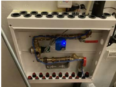
Vannfordelerskap i bod ved carport.
