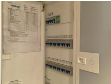
Sikringsskapet i entre.
