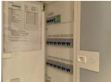
Sikringsskapet i entre.
