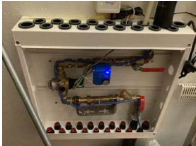
Vannfordelerskap i bod ved carport.
