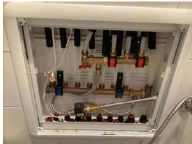
Vannfordelerskap i bad i 1. etg.
