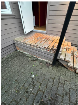
Fallhøyden er over 50 cm, da kreves rekkverk.
