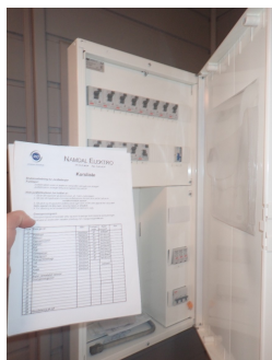
Sikringsskap med automatsikringer.
