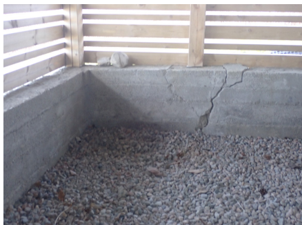
Sprekk i bankett / mur.
