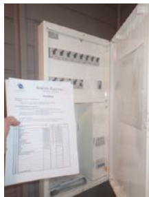
Sikringsskap med automatsikringer.
