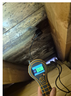
Misfarging av undertak. Ikke målt noe unormalt med fukt.
