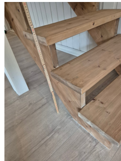
Mangler rekkverk i nederste del av trapp.
