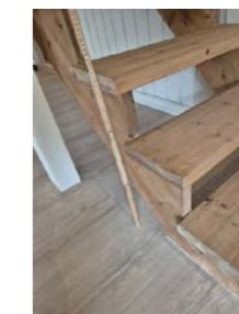
Mangler rekkverk i nederste del av trapp.
