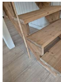
Mangler rekkverk i nederste del av trapp.
