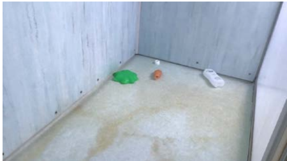
Fukt skader i nedkant våtromsplater i dusj
