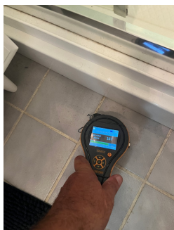
Overflatesøk på gulv ved kabinett
