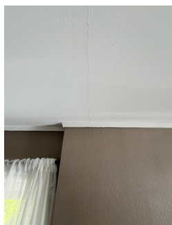
Liten sprekk i himling på stue 2 etasje
