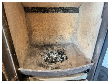
Sprekk i ildfast stein
