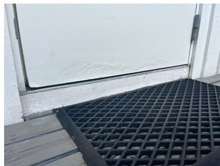
Fuktskadet felles ytterdør
