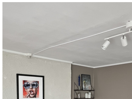
Ujevn overflate stue 2 etasje
