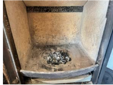
Sprekk i ildfast stein
