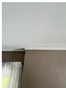
Liten sprekk i himling på stue 2 etasje
