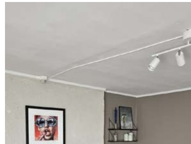
Ujevn overflate stue 2 etasje
