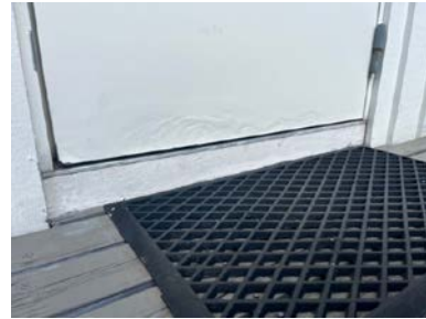
Fuktskadet felles ytterdør
