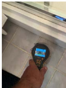
Overflatesøk på gulv ved kabinett
