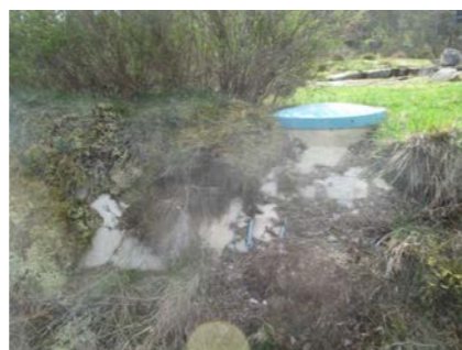
Avløp til tett septiktank.
