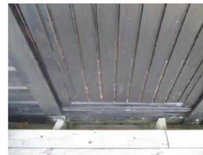
Utvendig brystning er slitt på balkongdør.
