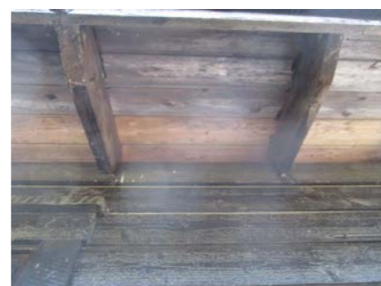
Ingen fluenetting eller musesikring ved luftespalte i mellom sperrer.
