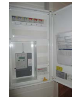
Sikringsskapet er plassert i gangen.
