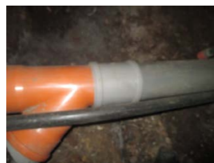
Avløpsrør av plast under hytta.
