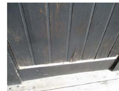
Utvendig finer på hoveddøren er skadet.
