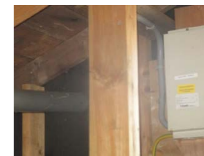
Inntak på kaldtloftet.
