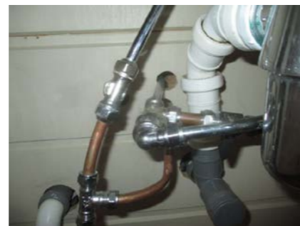
Noe synlig rørpropp på bad.
