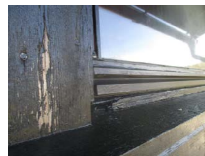
Gjennværende brukstid er begrenset på enkelte vinduer.
