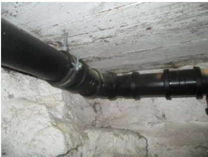
Avløpsrør av plast.
