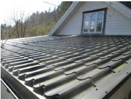
Deler av tekking på tilbygget del.
