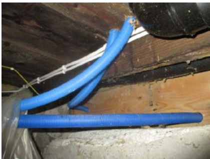
Deler av rør i rør systemet.
