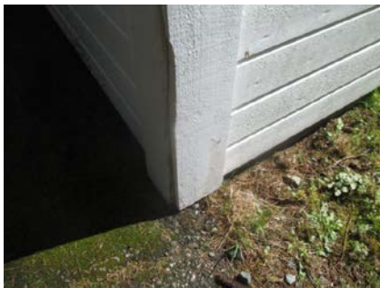
Kledningen ligger noe nær bakkenivå på ene hjørne.
