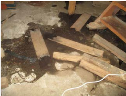
Noe fuktighet og innsig i grovkjeller.
