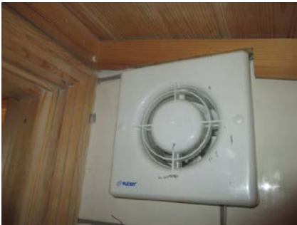
Vifte i ytterveggen.
