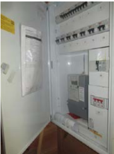
Sikringsskapet er plassert i entre i tilbygget del.
