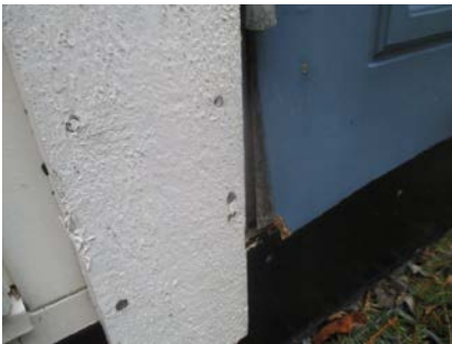
Skade på ytterdør til entre.
