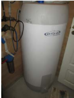
Bereder er plassert på teknisk rom.
