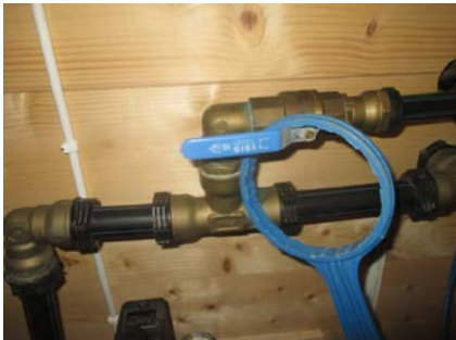
Innvendig stoppekran på teknisk rom.
